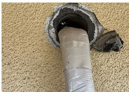
エアコンダクト
